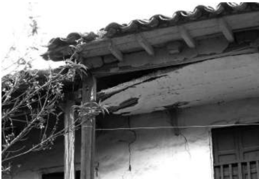
Figura 6. Patología en maderas por humedades. Fotografía del autor.
