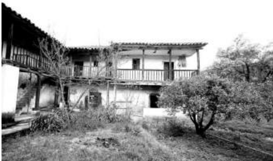
Figura 5. Estado inicial con elevado deterioro, vista casa del claustro. Fotografía del autor.
