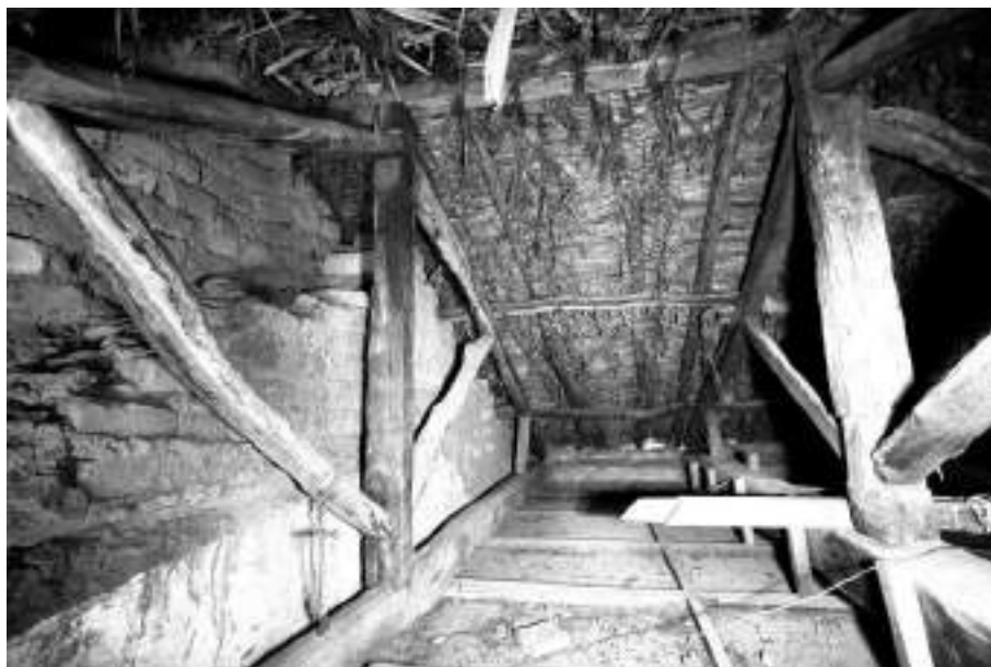
Figura 9. Daños de cubierta, intervención anterior. Fotografía del autor.
